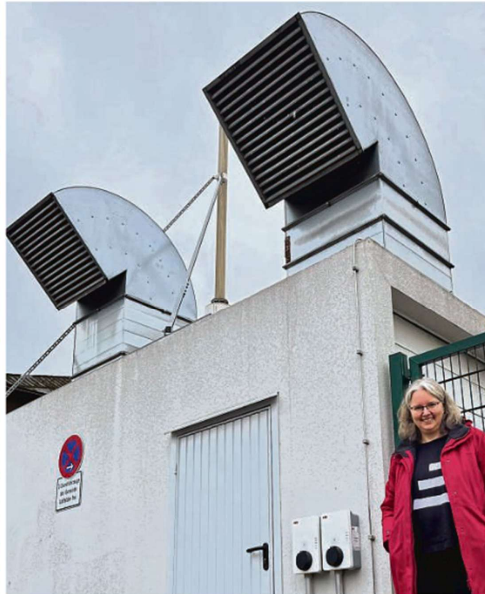
Setzt sich für Klimaschutz ein: Ursula Paul vor einem der Blockheizkraftwerke der Gemeinde und den neuen Lademöglichkeiten für E-Fahrzeuge.
